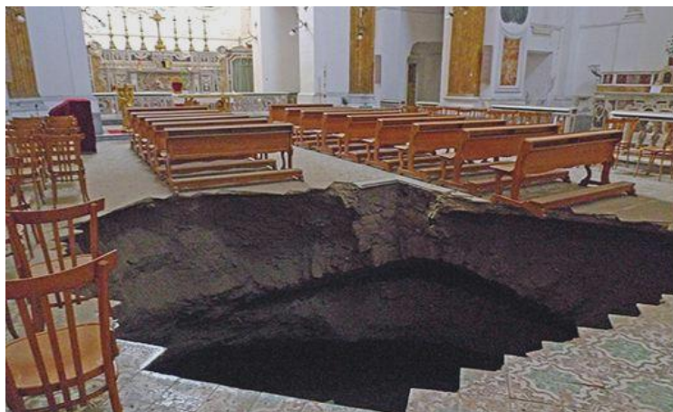
Fot. Kościół San Carlo alle Mortelle w Neapolu po katastrofie.
